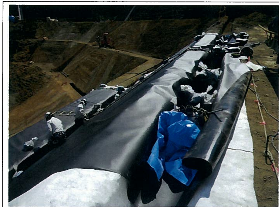
④所定の部分まで引き出した後、透明土嚢で仮押さえを行う。 ※透明土嚢は、内部の確認ができる。
