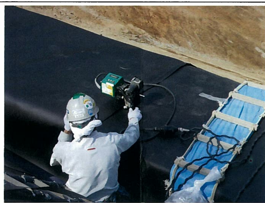
⑤シートとシートを所定の幅で重ね合わせ自走式融着機で接合する。 ※溶接面のゴミ、ホコリ等をウエス等で取り除きながら融着する。 ※設置完了しているシートとの接合にはエタノールを用いる。
