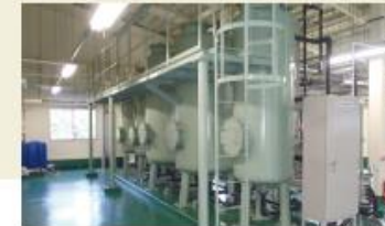
高度処理設備
