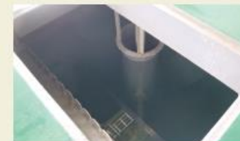
凝集沈殿処理設備
