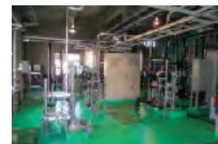
◆ 浸出水処理室
