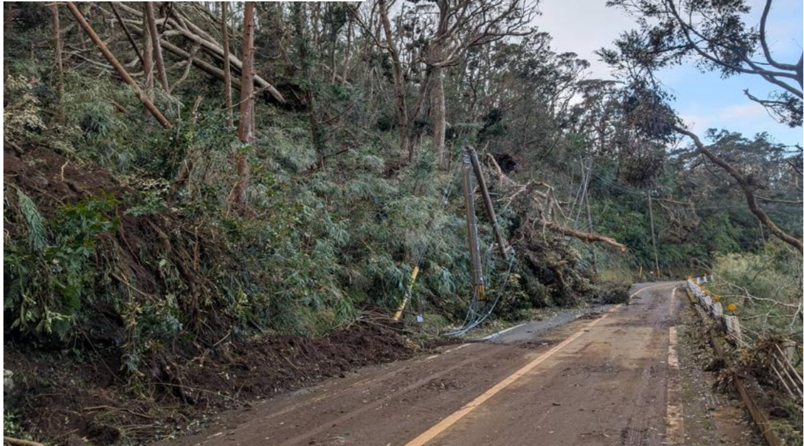
写真 2: 登龍道路(三根側ルート)被害状況 写真(撮影:2025 年 10 月 17 日)
