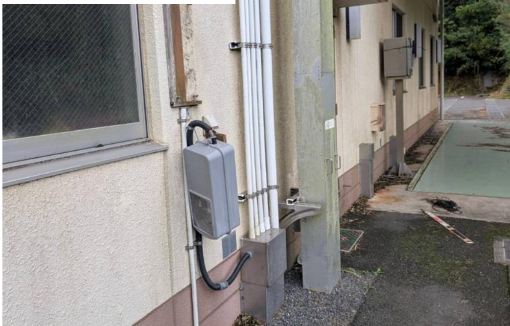
写真 10「電気メーター脱落状況」
