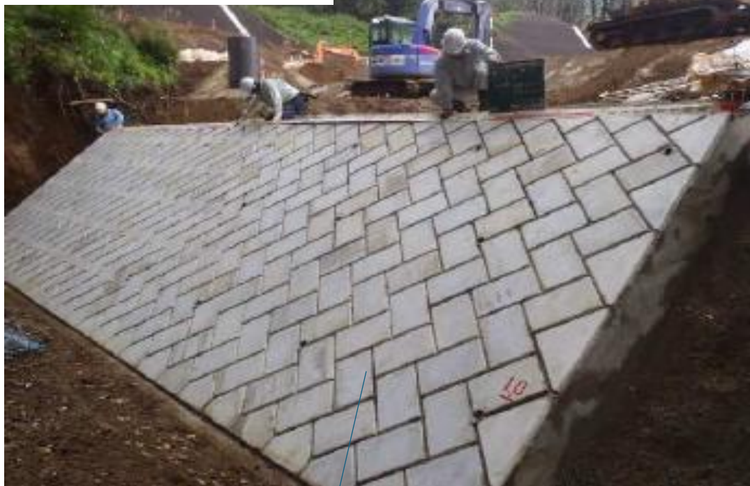
写真 1「上流井戸付近ブロック壁」
